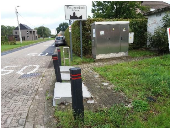
Figuur 1: bestaande pompstation met laagspanningsbord
